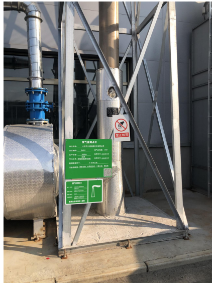
图 4-6 本项目排口标识牌
