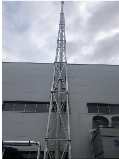
图 4-2 扩建项目 25 米高排气筒
